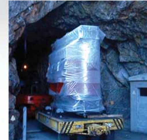
Transformátor v extrémních podmínkách hlub. dołu
